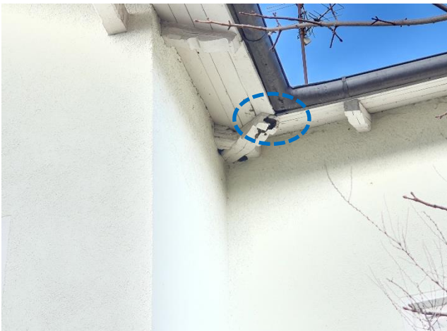
Abb. 3: Blick auf Fassade (Ostseite); zu erkennen ist die eingefaulte Pfette; darin befindet sich ein Vogelneest
