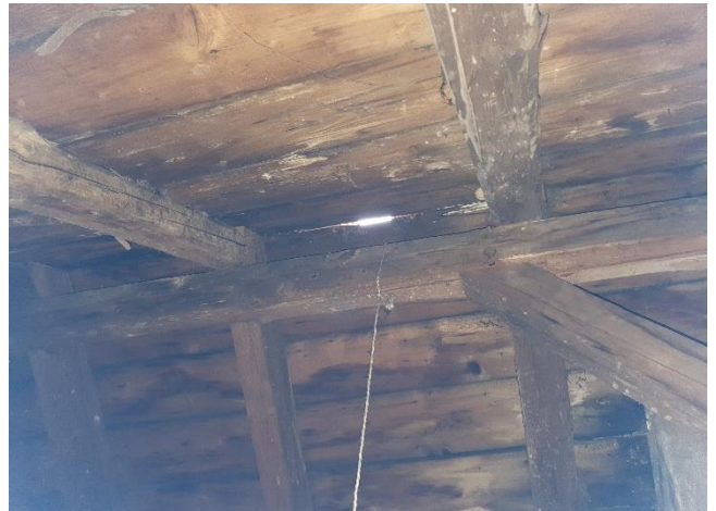
Abb. 8: Blick auf First im Dachstuhl, zu erkennen Undichtigkeit und verfärbte Balken durch eintretendes Regenwasser
