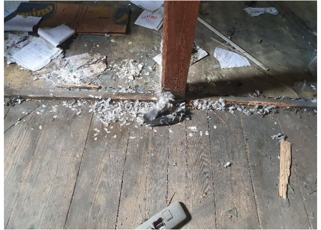
Abb. 6: Standort im Dachstuhl, zu erkennen tote Taube
